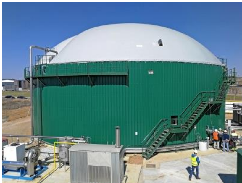
Figura 64: Planta de biogás de residuos agro-alimentarios de Tuero, ubicada en Venta de Baños (Palencia). Fuente. https://www.energias-renovables.com/biogas/la-planta-de-biogas-de-tuero-produce-20200430 .
